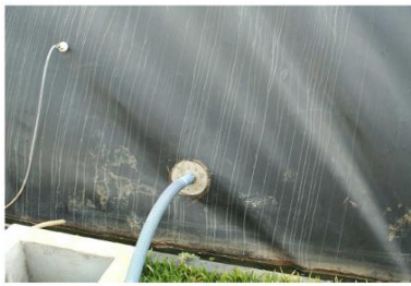
Figura 14 - Saída do biogás
